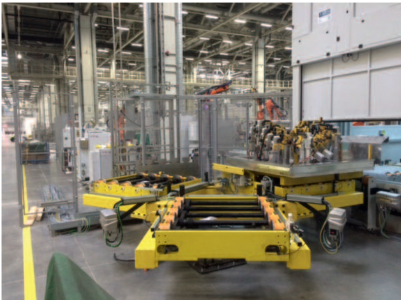
Drehtisch als Speicherzone vor Bearbeitungszelle
